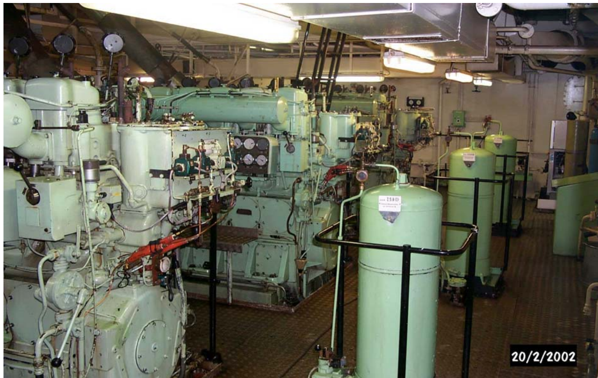
Abb. 3: Blick auf die Hilfsdiesel im Hilfsdieselraum auf SB "Nordsee"
