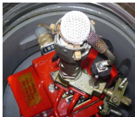
Abb. 2: Gasbrenner einer Gaslaterne
