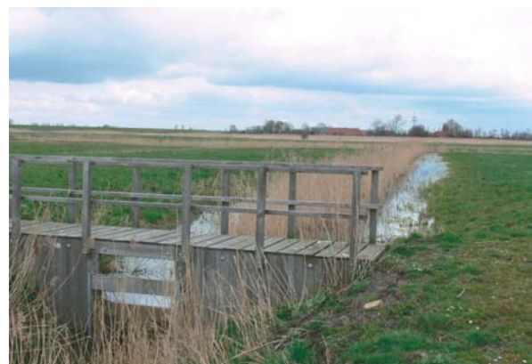
Bild 8: Aufgestauter Graben mit Stauwehr
